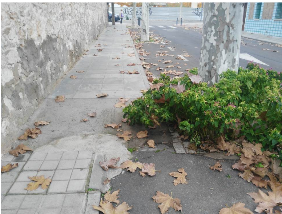
Detalle del encuentro entre diferentes anchos y tipos de baldosas del acerado de la margen derecha al comienzo de la vía.
