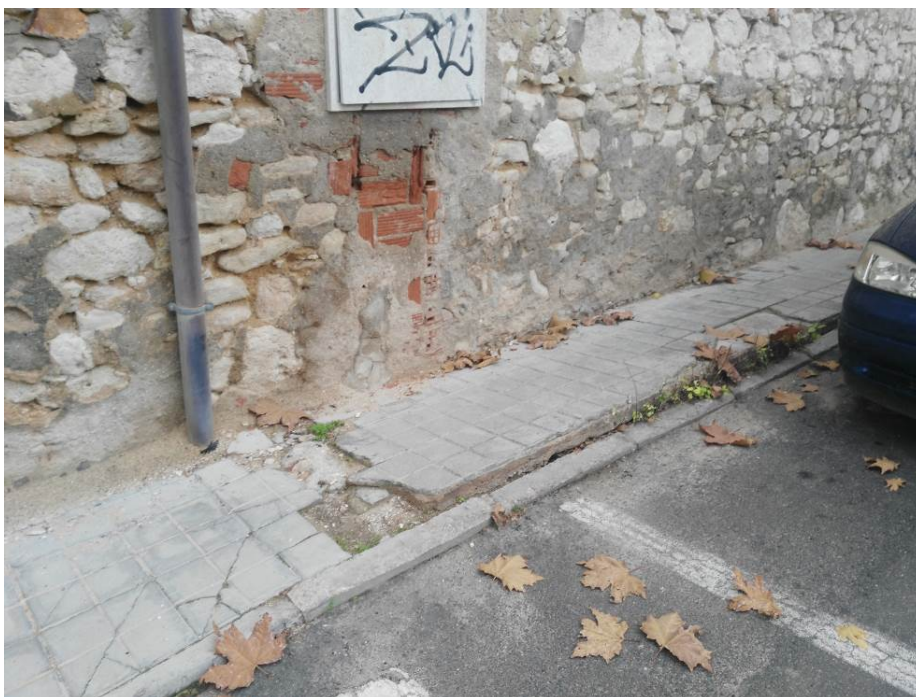
Acerado de 1m de anchura en la margen derecha de la calle, que presenta desperfectos ocasionados principalmente por raíces de árboles.
