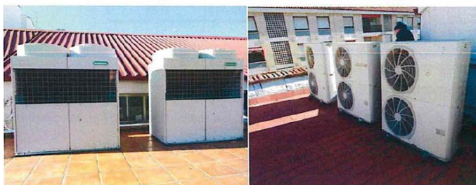
Unidades exteriores situadas en terrazas a la vía pública y al patio interior del edificio.
