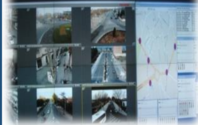
Centro de Control
